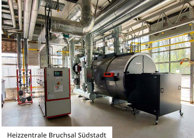
Heizzentrale Bruchsal Südstadt
