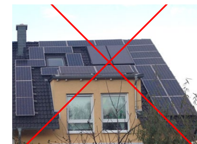
Kollektoren in unterschiedlicher Ausrichtung und Größe auf einer Dachfläche
