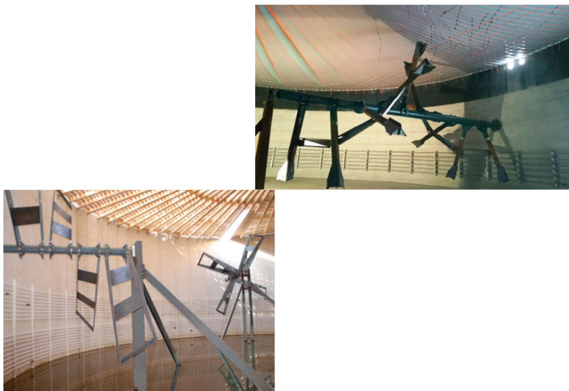
Abbildung 6: Blick in einen Rührwerksbehälter mit Paddelrührwerk
